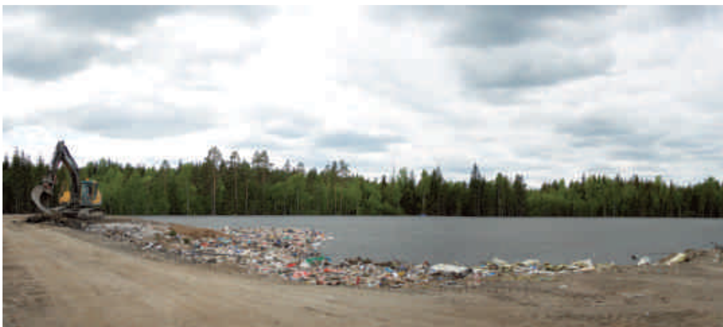
Den gamla soptippen på Gryta avslutas och en ny byggs. Anledningen är nya regler som bestämmer hur en deponi ska vara uppbyggd. Den nya tippen ska täcka hela regionens deponering för 50 år framåt. De som lämnar material till VafabMiljös deponi kan vara säkra på att avfallet tas omhand på bästa möjliga sätt.
