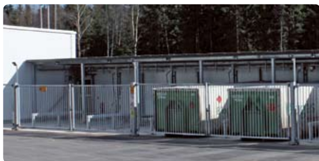
Fyllning av mobila gaslager, för leverans till tankstationer i Stockholmsområdet.
